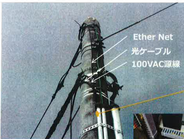
No.41柱配線状況
