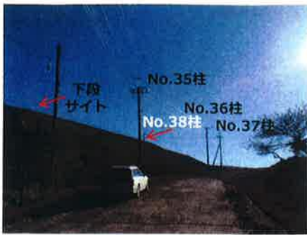
2Kmにおよぶ私設高圧送電線路
