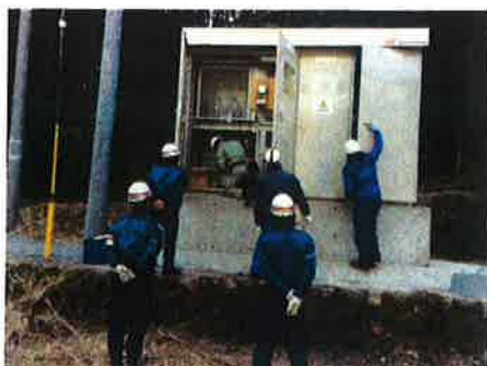
電気主任技術者 須田さんによる2次側接地確認
