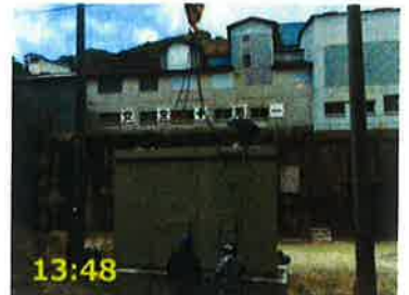
高圧送電盤(送)据付完了
